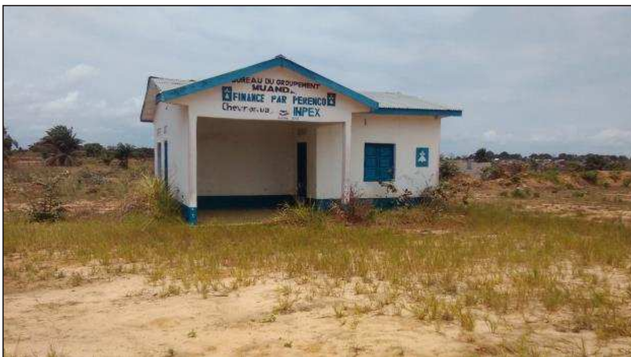
Photo 8 : Le bureau du groupement Muanda construit par PERENCO à Muanda village en 2013 dans le volet social bénévole pour un montant non communiqué, en état d'abandon depuis son inauguration.
