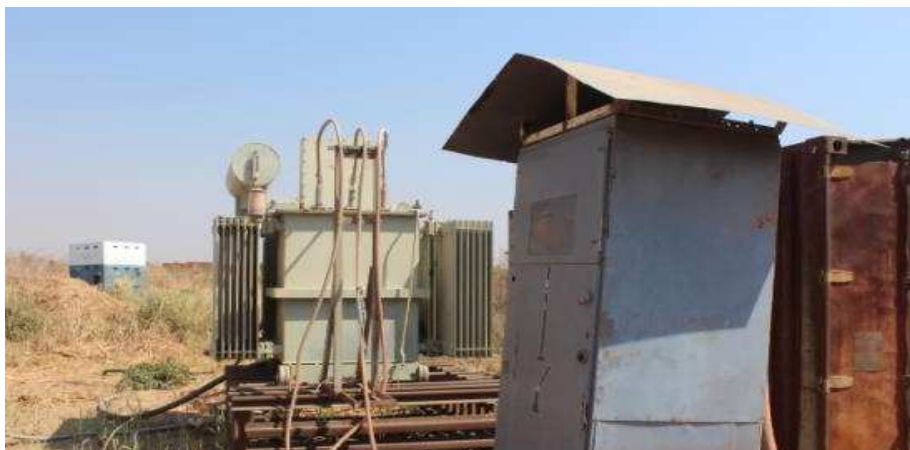
Photo 25 : Transformateur qui alimente l'UNIKOL
